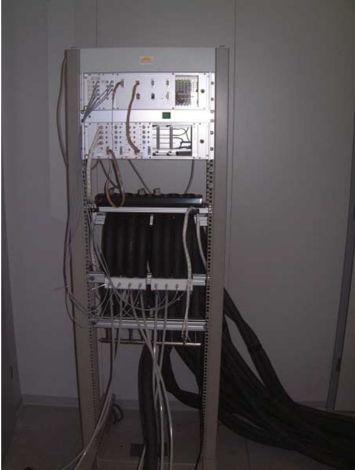
Abbildung 21: Fotografie einer Steuereinheit. In der oberen Bildhälfte befinden sich zwei 19-Zoll Einschübe für die Elektronik. Im mittleren Bereich der Fotografie befinden sich die PT 100 Sensoren des Überlaufes mit ihrer Verkabelung.
